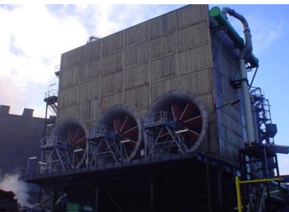
Unités de traitement d'air de 2,5 MW
